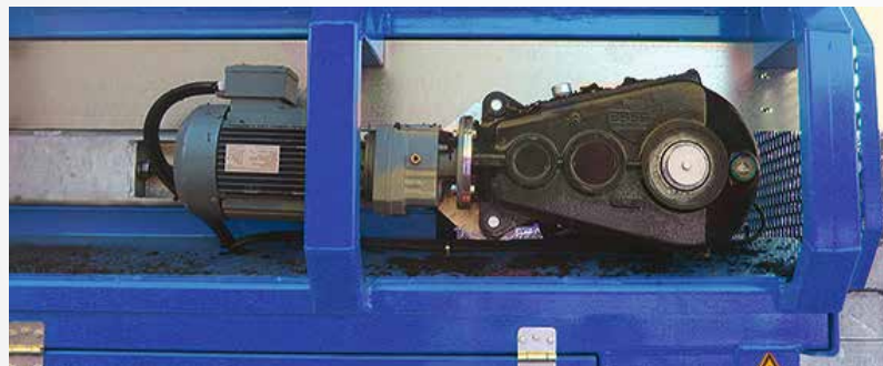
Elektrinė bunkerio transporterio pavara
